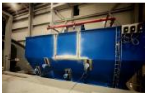
Figura 4 - Tolva de receção/dosagem. (Fonte: Elementos adicionais do EIA,2025)
